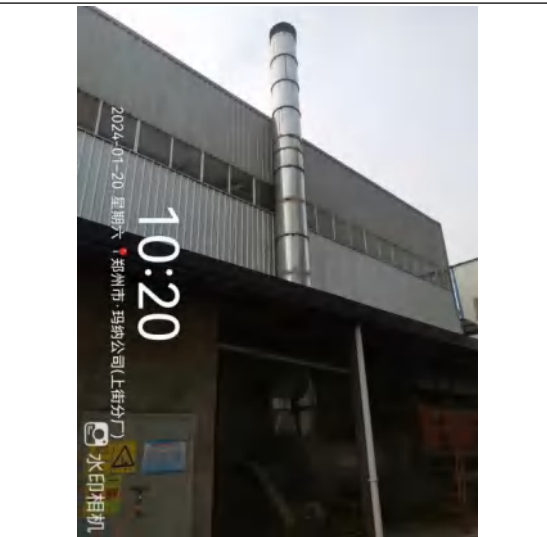
TA004 设施对应排气筒 DA003
