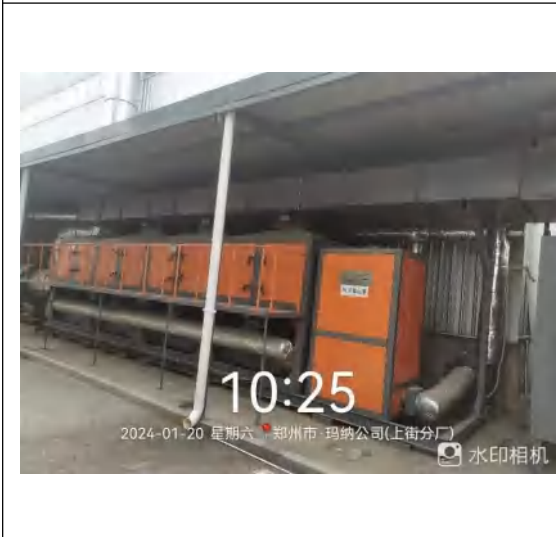
喷漆、烘干废气治理设施 TA004
